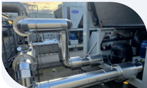
POMPES À CHALEUR
